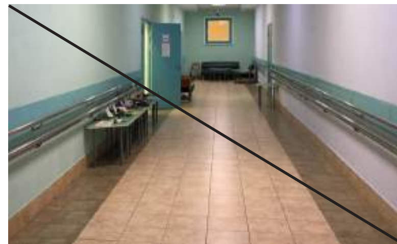
Плохо Керамогранитная плитка с крупными швами
